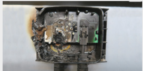
Bild 2: Verbrannte Anschlussdose durch korrodierte Kontakte
